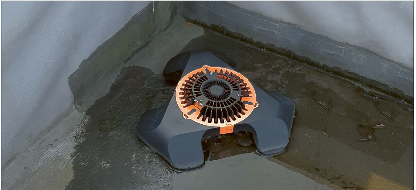
Bild 4: Die ROOFGUARDs wurden direkt auf den Dachgullys der Logistikhalle montiert – Laub oder Hagel haben die Entwässerung seither nicht mehr beeinträchtigt.
