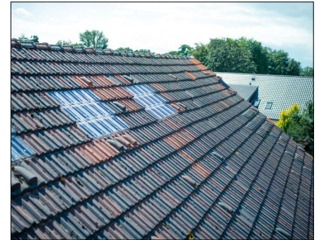
Bild 4: Insgesamt 70 m 2 ausschmelzbare Fläche in Form von FLECK-Lichtpfannen aus Kunststoff wurden auf dem Dach der Ziegelei montiert, um die Anforderungen an den Brandschutz zu erfüllen.
