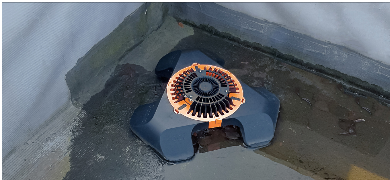
Bild 4: Die ROOFGUARDS wurden direkt auf den Dachgullys der Logistikhalle montiert – Laub oder Hagel haben die Entwässerung seither nicht mehr beeinträchtigt.
