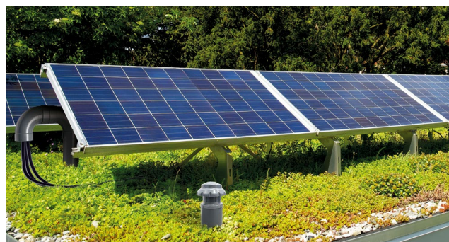
Kombination von Gründach und aufgeständerter PV-Anlage.
