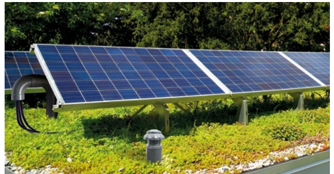
Kombination von Gründach und aufgeständerter PV-Anlage.
