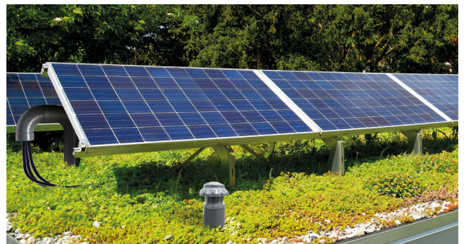
Combinatie van een groendak en een verhoogde PV-installatie.
