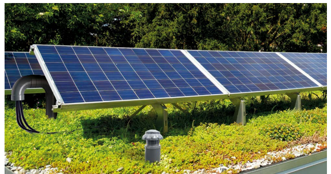
Kombination von Gründach und aufgeständerter PV-Anlage.
